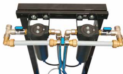
Detail obchozího potrubí
